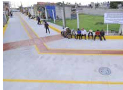
Concreto hidráulico en calle cuauhtémoc tramo de calle Revolución a calle Miguel Hidalgo, San Mateo Mozoquilpan.
