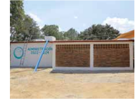
construcción de tanque público de agua potable y construcción de línea de llenado en zona de depósitos, San Agustín Mimbres.
