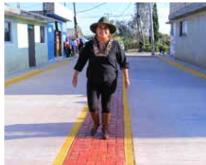
Concreto hidráulico y rehabilitación de banquetas en calle independencia, Ejido de Mozoquilpan.
