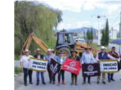
Inicio de ampliación de Drenaje sanitario en calle Real del Oro y calle Independencia Barrio Las Trojes.
