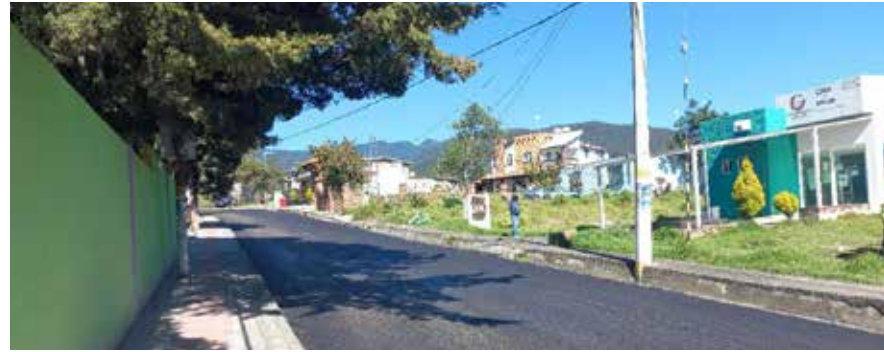
Mezcla asfáltica en la carretera a San Mateo Capulhuac, Concepción de Hidalgo y San Mateo Capulhuac.
