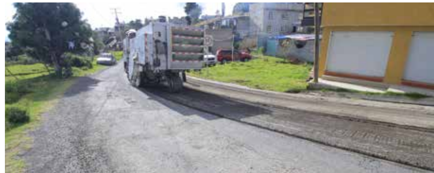
Mezcla asfáltica de la carretera a Santa Ana Jilotzingo, Santa Ana Jilotzingo.
